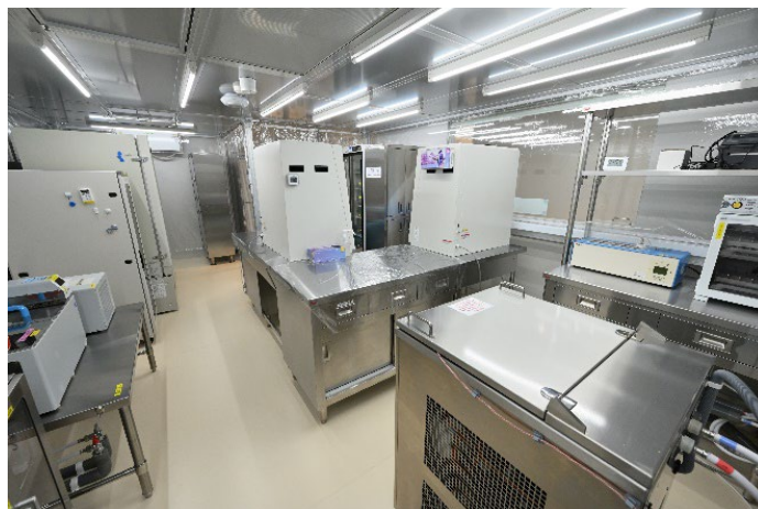
《リニューアル後のクリーンルーム》
